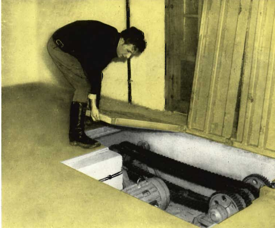
Unterflur-Kettenantrieb der Schubstangen-Entmistungsanlage für Rinder
